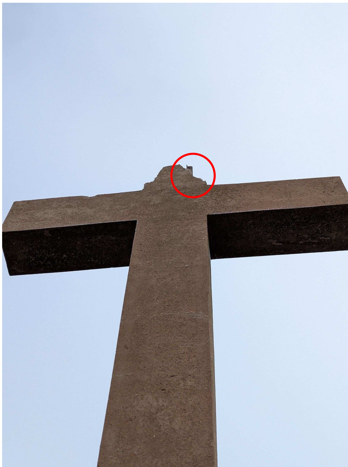
Foto 2: Daños en la parte superior de la cruz y exposición del hierro que arma la estructura.
